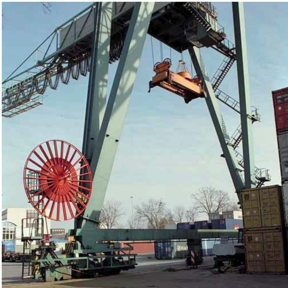
Leitungswagenanlage für Containerkrane
