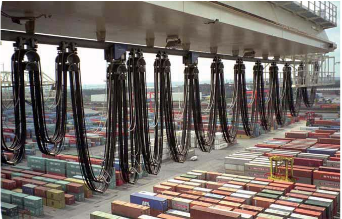
Angetriebene VAHLE-Leitungswagen im Hamburger Hafen
